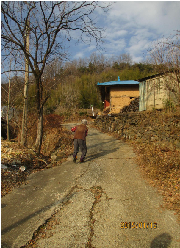
보행이 어렵고 파손된 마을 안길
