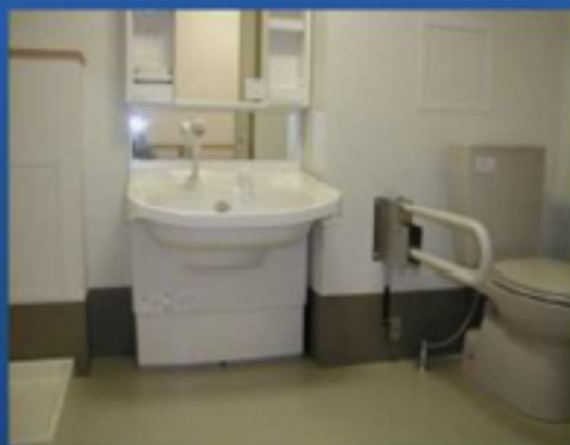
[ 시즈오카현 공영아파트의 유니버설 디자인 도입 사례] (원채어 대응 화장실)
