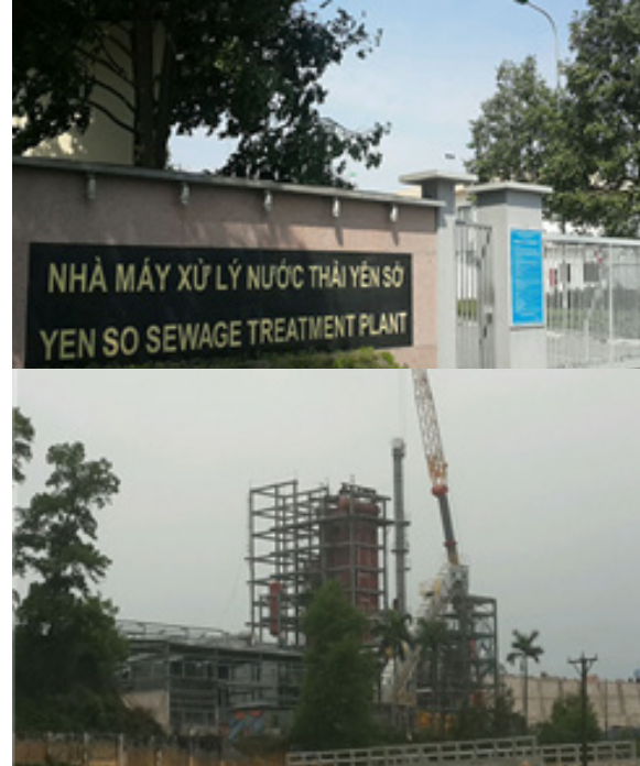
상) 하노이 하수처리시설 하) 공사 중인 하노이 생활폐기물 소각처리시설
