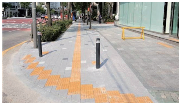
▲ 횡단보도 앞 선형블록이 횡단 방향과 같은 방향으로 설치된 사례
