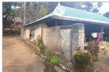
노후화된 주택(담장, 대문, 지붕 등)
