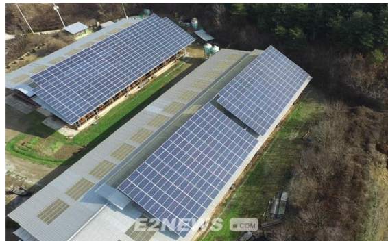
자료: 이투뉴스(19.03.19) 경북 영주시내 돈사내 태양광발전 활용 사례
