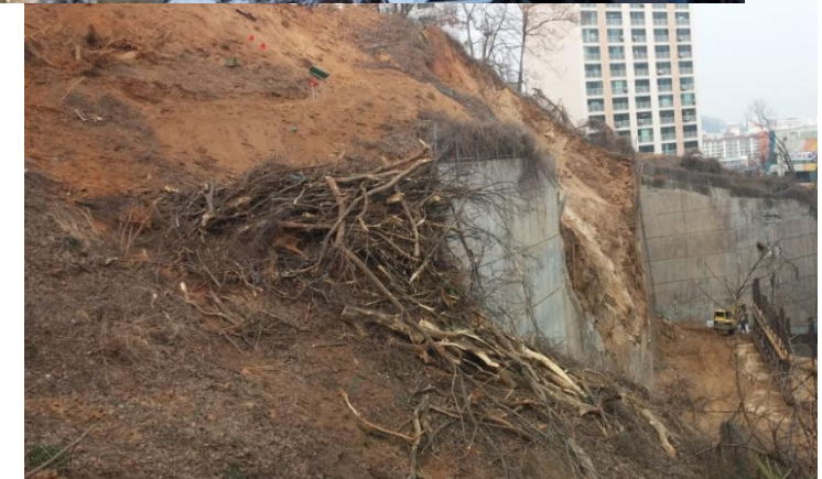
&lt;붕괴 후 옹벽 사진&gt;
